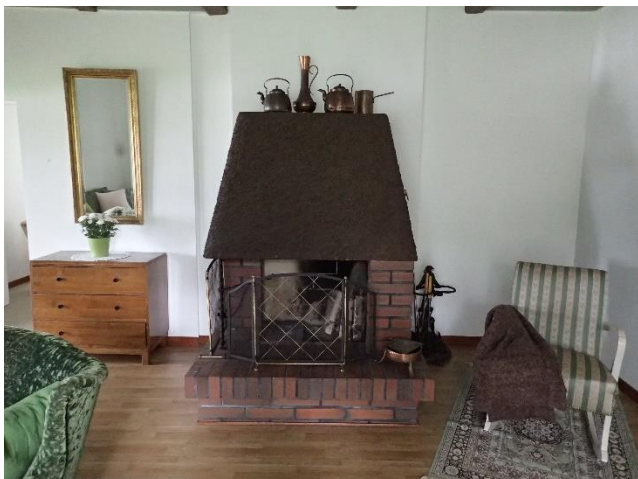
Olohuoneen avotakka, kipinäsuoja puuttuu.
