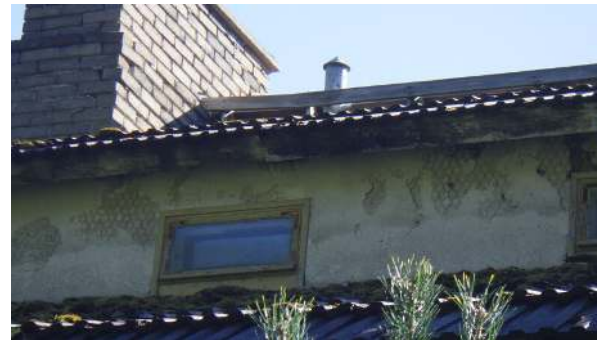
22. Seinän yläosassa vaurioita.
