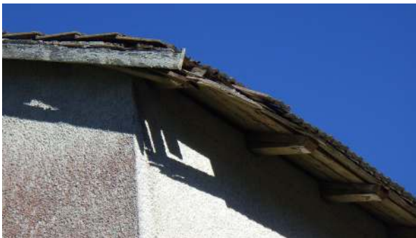
31. Kattorakenteiden vaurioiden vuoksi tiiliä saattaa tippua katolta
