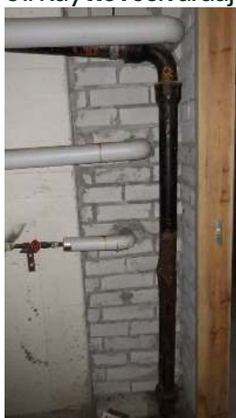
53. Viemäriputki ruostunut puhki
