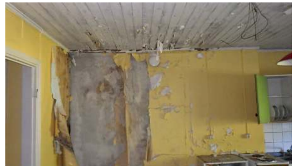
38. Sisäkatto notkuu. Vuotoja
