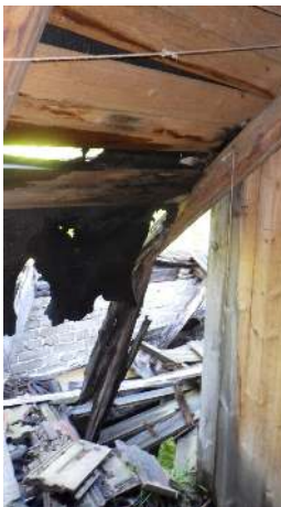
37. Sivu-ullakkotila. Katto- ja välipohja sortunut kattovuotojen vuoksi
