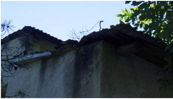
19. Kattorakenne sortunut ja seinä altistuu kosteudelle/vedelle
