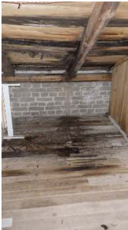
35. Sivu-ullakkotila. Kattorakenteissa vaurioita
