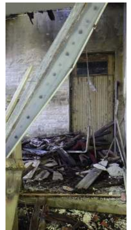
24. Välipohja- ja kattorakenteet sortuneet kuvassa olevan sisäänkäynnin kohdalla
