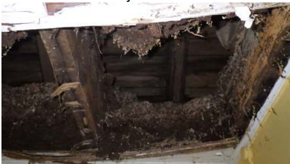
39. Sisäkatto sortunut ja yläpohjan turve-eriste tippunut sisälle
