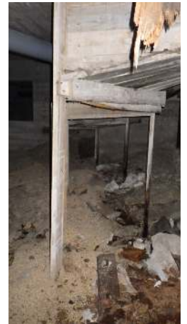
6. Ryömintätilan pohjalla havaittiin organista materiaalia ja rakennusjätettä
