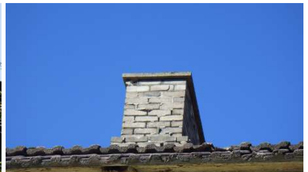
34. Piipun yläosassa rapaumaa ja irronneita tiiliä
