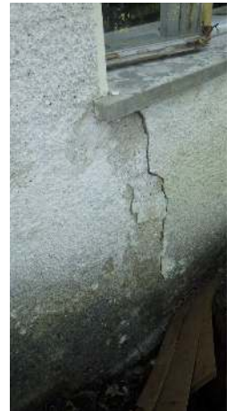
20. Halkeama seinässä. Seinän alaosa märkä
