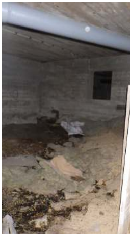
7. Ryömintätilan pohjalla havaittiin orgaanista materiaalia ja rakennusjätettä.
