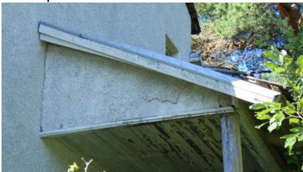
23. Kuistin katon puurakenteissa lahovaurioita
