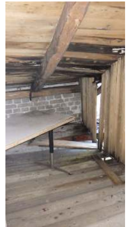
36. Sivu-ullakkotila. Kattorakenteissa vaurioita. Katto osin sortunut
