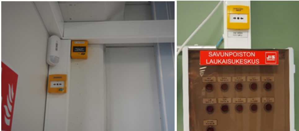
Ilmanvaihdon hätäseis -painikkeet D-sisäänkäynnillä ja B-sisäänkäynnillä.
