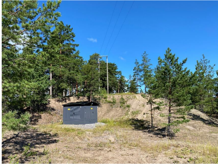
Muuntamo sekä 20 kV:n voimalinja kaava-alueen lounaisosassa.
