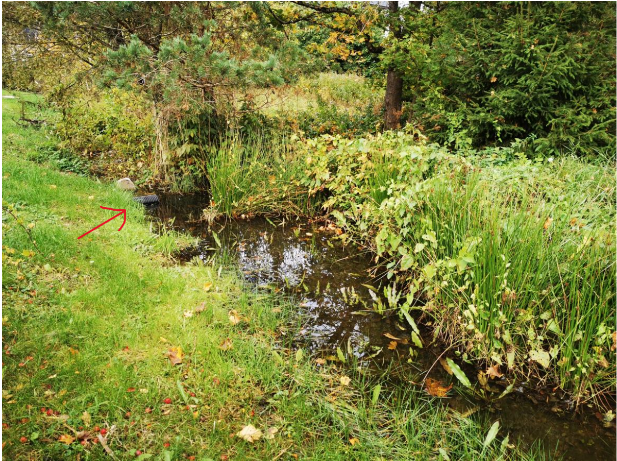
Vettä rajaojassa n. 10 cm syvyydeltä ja hulevesijärjestelmän putken pääty
