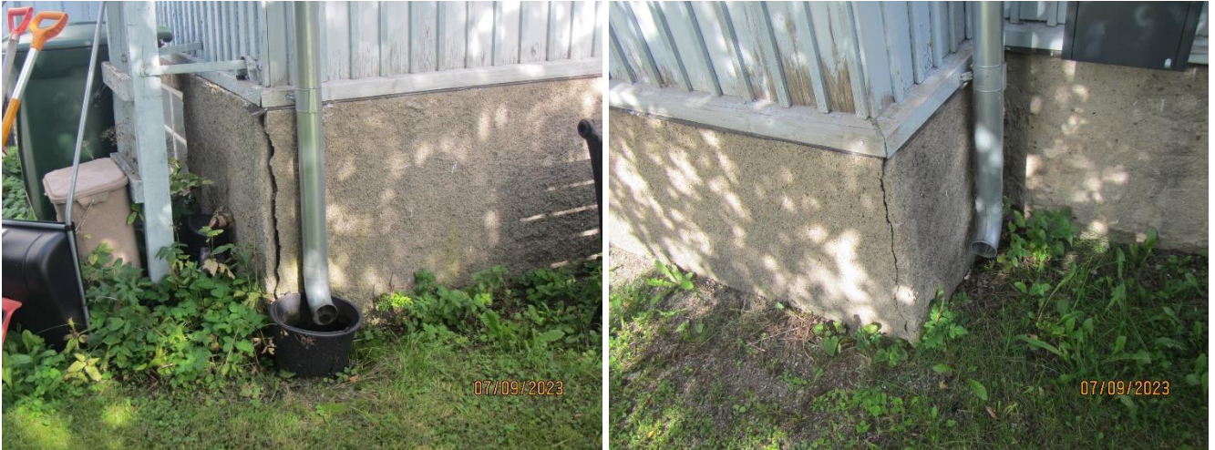
Bild 3-4. Sockeln har ställvis spruckit upp.
