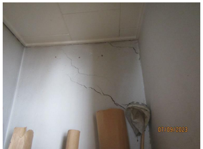
Bild 40. Sprickor i väggarna.
