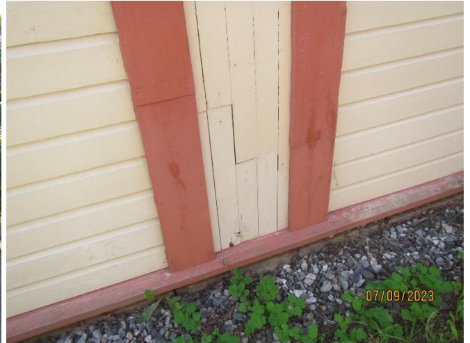
Bild 12. Brädfodringen har förnyats ställvis.
