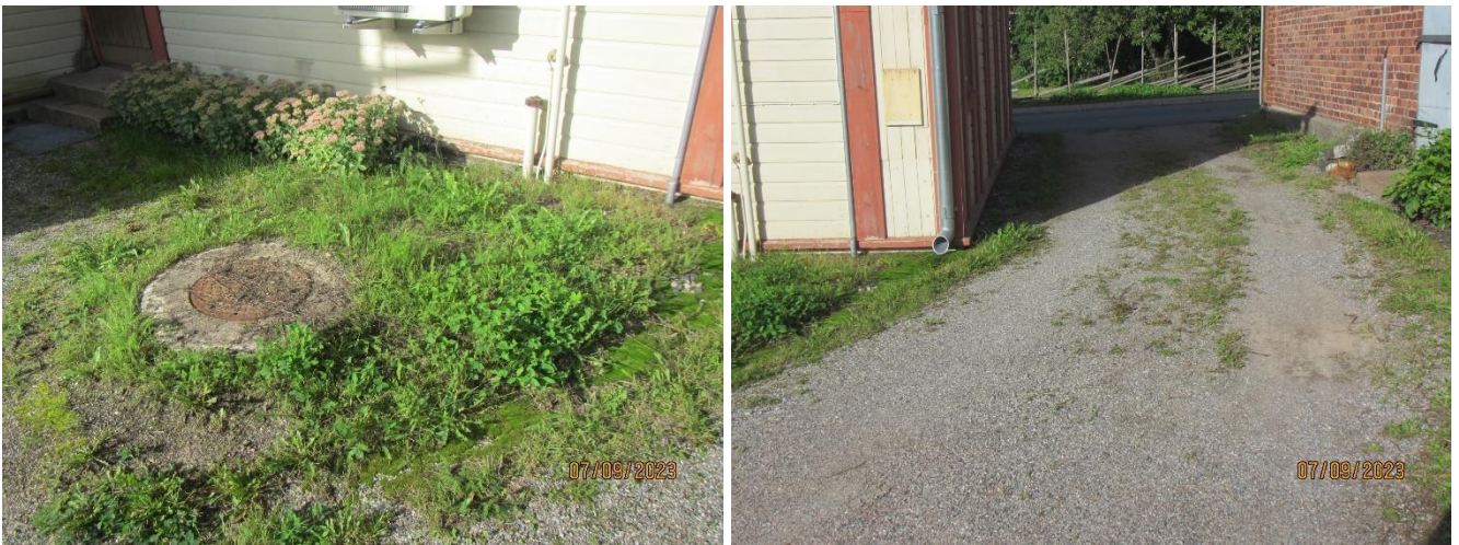
Bild 57-58. Marklutningen är ställvis rätt dåligt från byggnaden sluttande.
