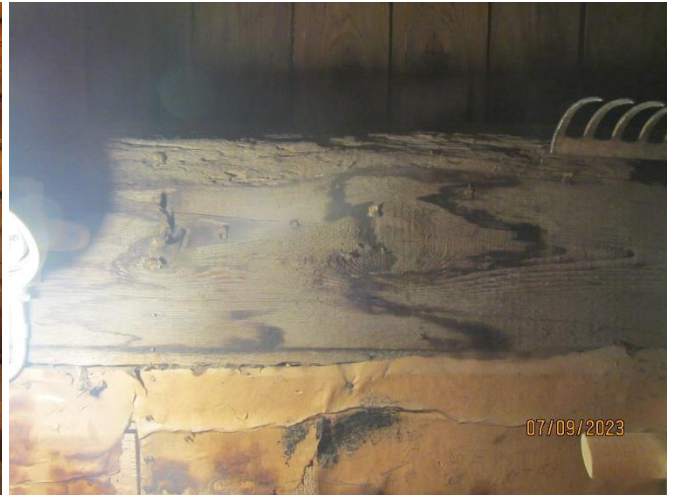
Fuktspår på stockarna högre upp på väggen.
