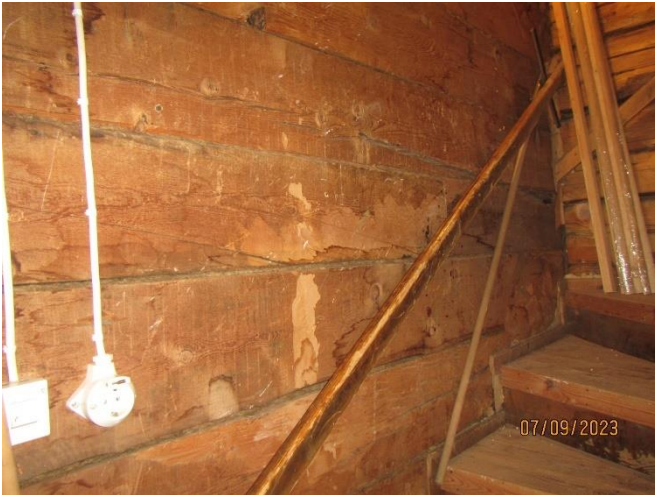
Bild 13-14. Stockväggen i trapphuset.
