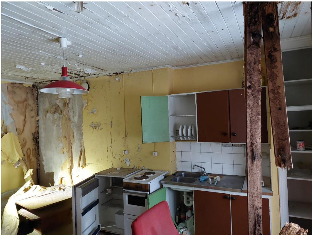
Samtliga utrymmen i byggnaden ha vatten- röt och mögelskador.
