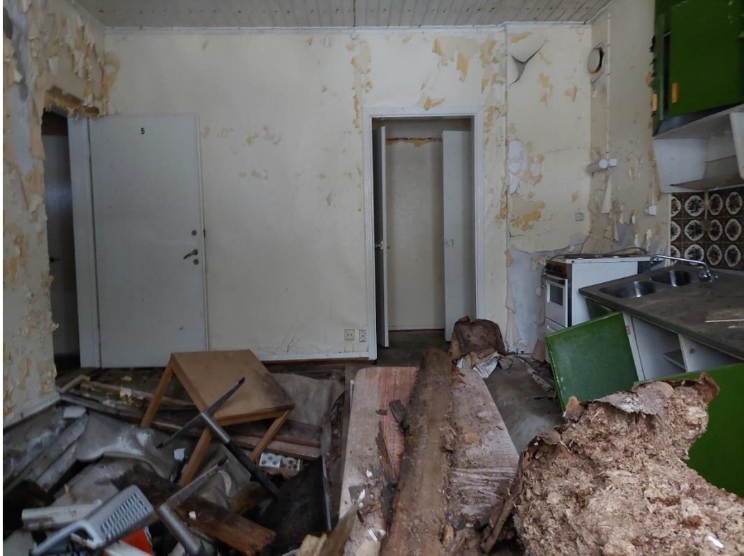
Golvkonstruktionen har gett vika.
