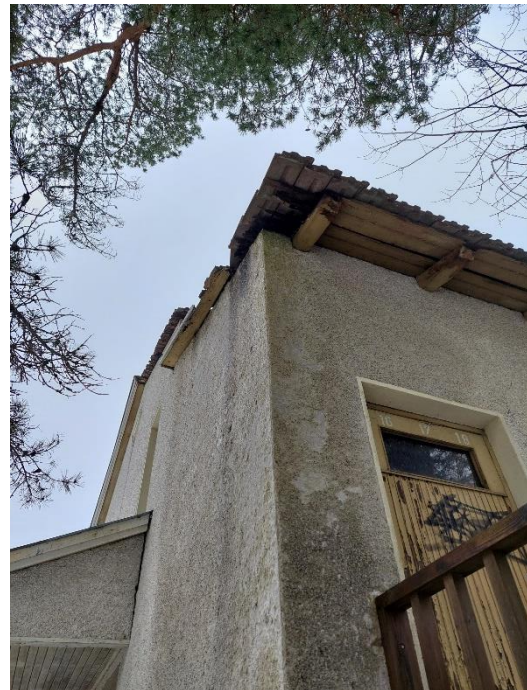
Byggnadens täckor har rasat
