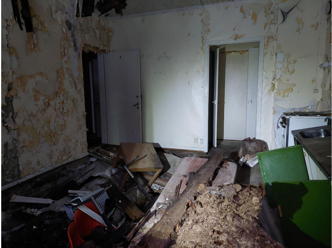
Byggnadens innertak har delvis rasat
