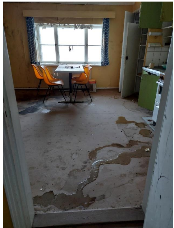
Vattenskador i alla rum
